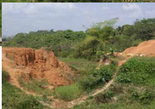
Dique Marginal en el sitio "Doña Julia", destruido por la acción de la lluvia.
